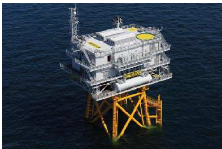
Figure 5 : Poste électrique en mer du parc éolien de Walney, fourni à titre d'illustration (source : étude d'impact)
